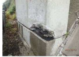
愛宕山橋 :PCラーメン橋 (東北道の跨道橋) 判定区分Ⅱ(健全度C) 橋脚(垂直材)に剥離・鉄筋露出あり。 凍結防止剤に起因する塩害により、内部鋼材の腐食が進行する可能性がある。
