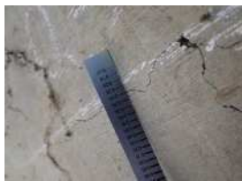
借宿橋 :鋼I桁橋 (釈迦堂川を跨ぐ長大橋) 判定区分Ⅱ(健全度C) 床版下面に最大幅0.3mmの二方向のひびわれあり。 通過車両による繰り返し荷重により、損傷は進行する可能性あり。
