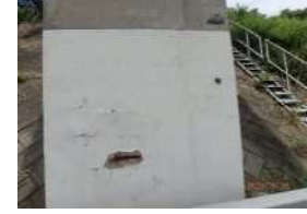
池ノ下橋 :PCラーメン橋 (東北道の跨道橋) 判定区分Ⅱ(健全度C) 橋脚(垂直材)に剥離・鉄筋露出、うきあり。 凍結防止剤に起因する塩害により、内部鋼材の腐食が進行する可能性がある。
