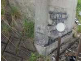
館越橋 :PCラーメン橋 (東北道の跨道橋) 判定区分Ⅲ(健全度D) 橋脚(垂直材)に剥離・鉄筋露出、うきあり。 凍結防止剤に起因する塩害により、内部鋼材の腐食が進行する可能性が高い。 ※令和6年度補修工事予定。
