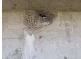
成竜橋 :PCT桁橋 (阿武隈川を跨ぐ長大橋) 判定区分Ⅱ(健全度C) ポステン桁ウェブ、上フランジ下面に剥離、鉄筋露出あり。 部材内部への雨水の浸入により、内部鋼材の腐食が進行する可能性がある。
