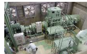
排水機場内部
