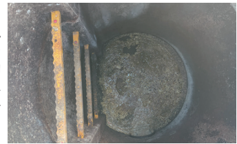
宅内排水桝に堆積した油脂類
