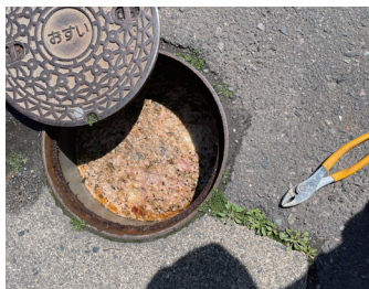
マンホールに堆積した油脂類
