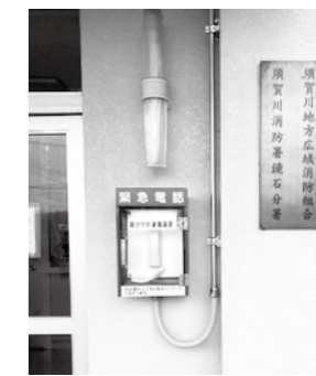
須賀川消防署鏡石分署に設置されている駆け付け通報装置
