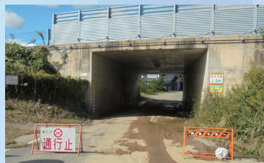
令和元年台風第19号による大雨で冠水した後の桜岡地内のアンダーパス
