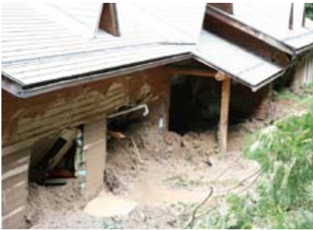
▲ふれあいの森管理事務所は、裏山が土砂崩れし 建物飲み込まれました
