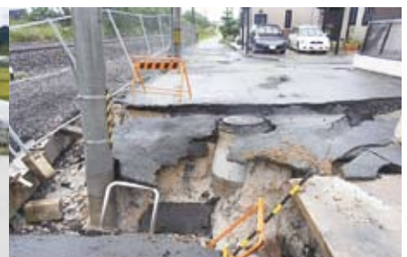
▲震災でダメージを受けた土地に雨水が入り被害が拡大しました
