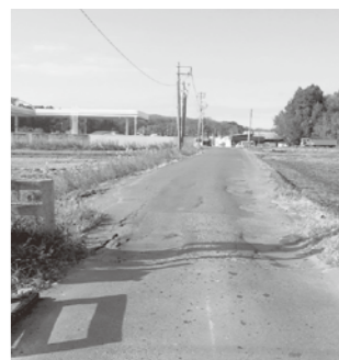
舗装劣化した農道
