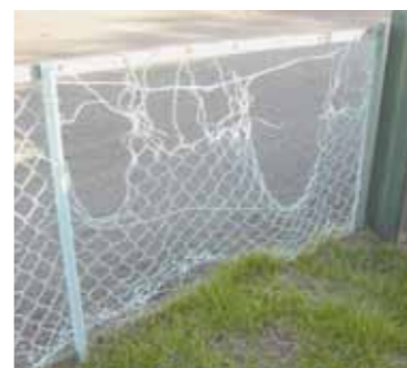
フェンス金網の落下状況
